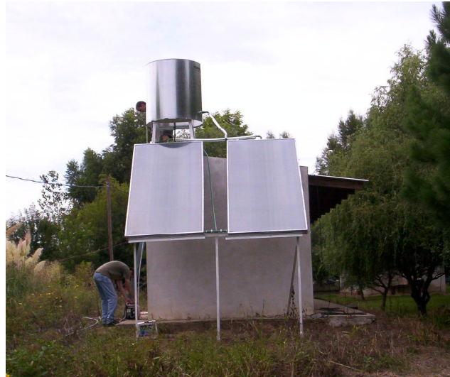
Figura 2. Vista de los colectores solares y el tanque.Camping “El Cielo”
